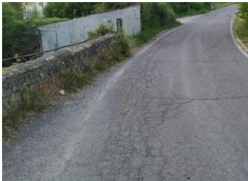
Figura 16. Vista sulla pavimentazione stradale dissestata
