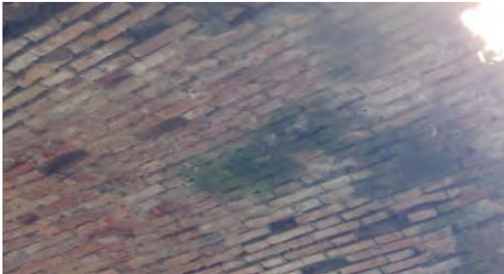
Figura 14. Esempio di infiltrazioni e muffe
