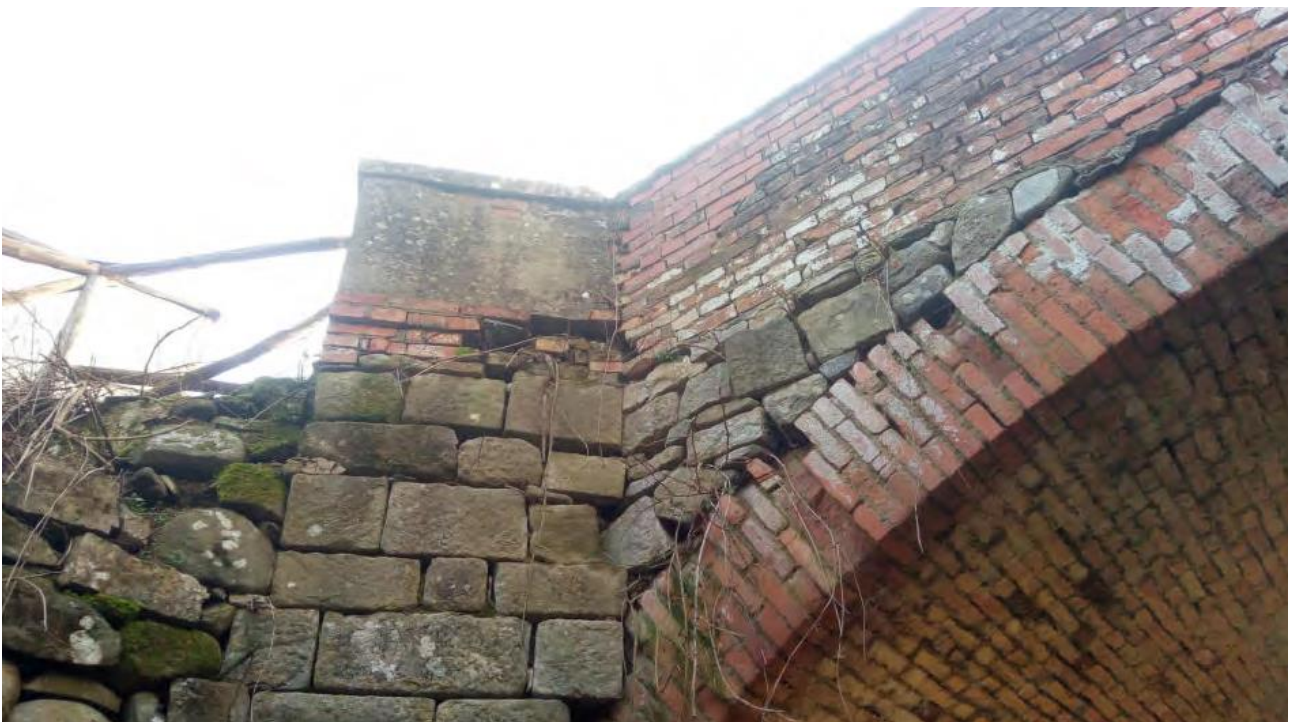
Figura 7. Degrado muro andatore e parapetto
