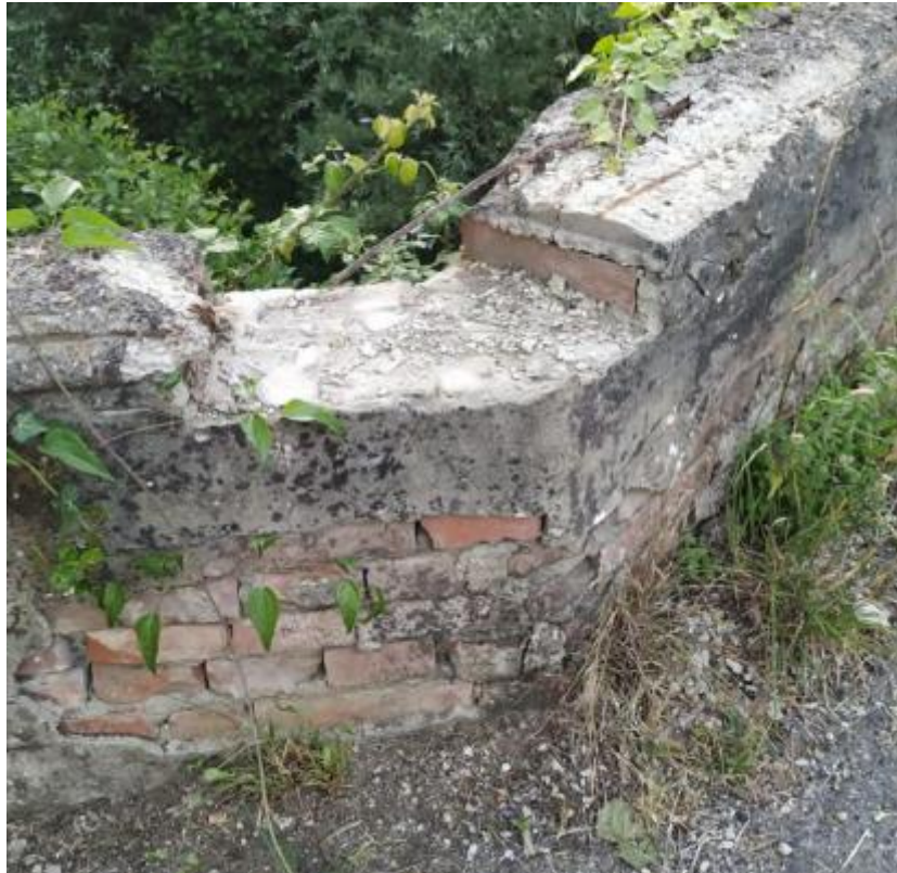
Figura 15. Vista di una porzione di parapetto danneggiata
