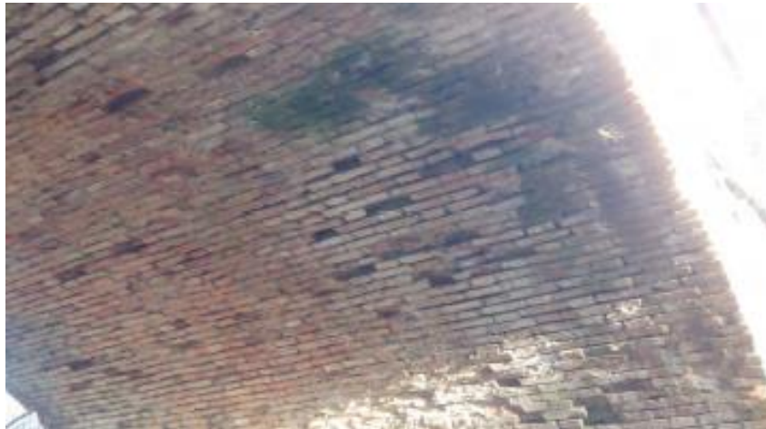
Figura 11. Esempio di distacco mattoni dalla volta
