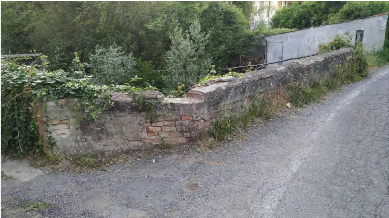
Figura 6. Degrado del parapetto in muratura
