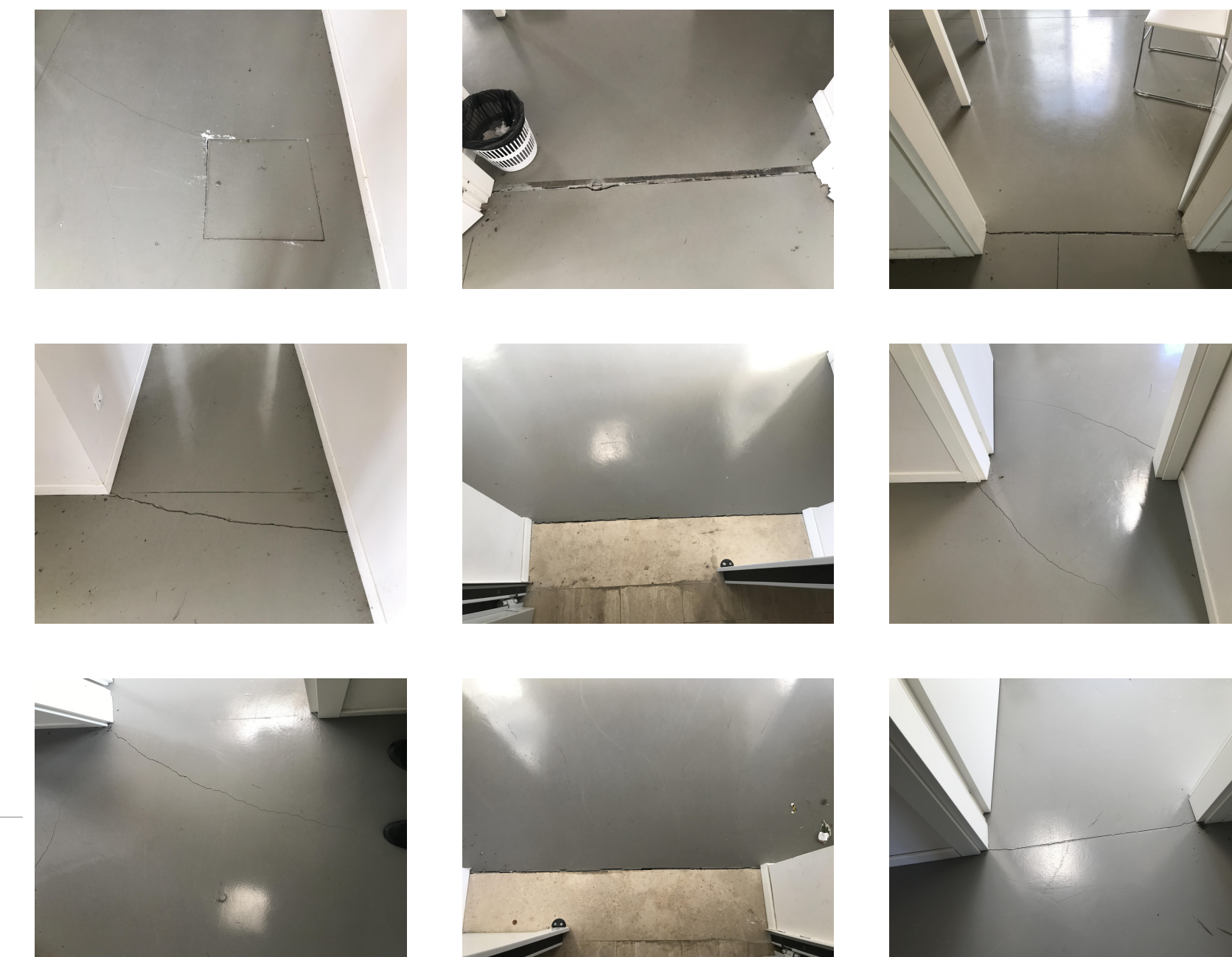
Rilievo fotografico delle fessurazioni presenti a pavimento nell'edificio esistente. Vedi riferimento posizione nelle piante dello Stato di Fatto.
