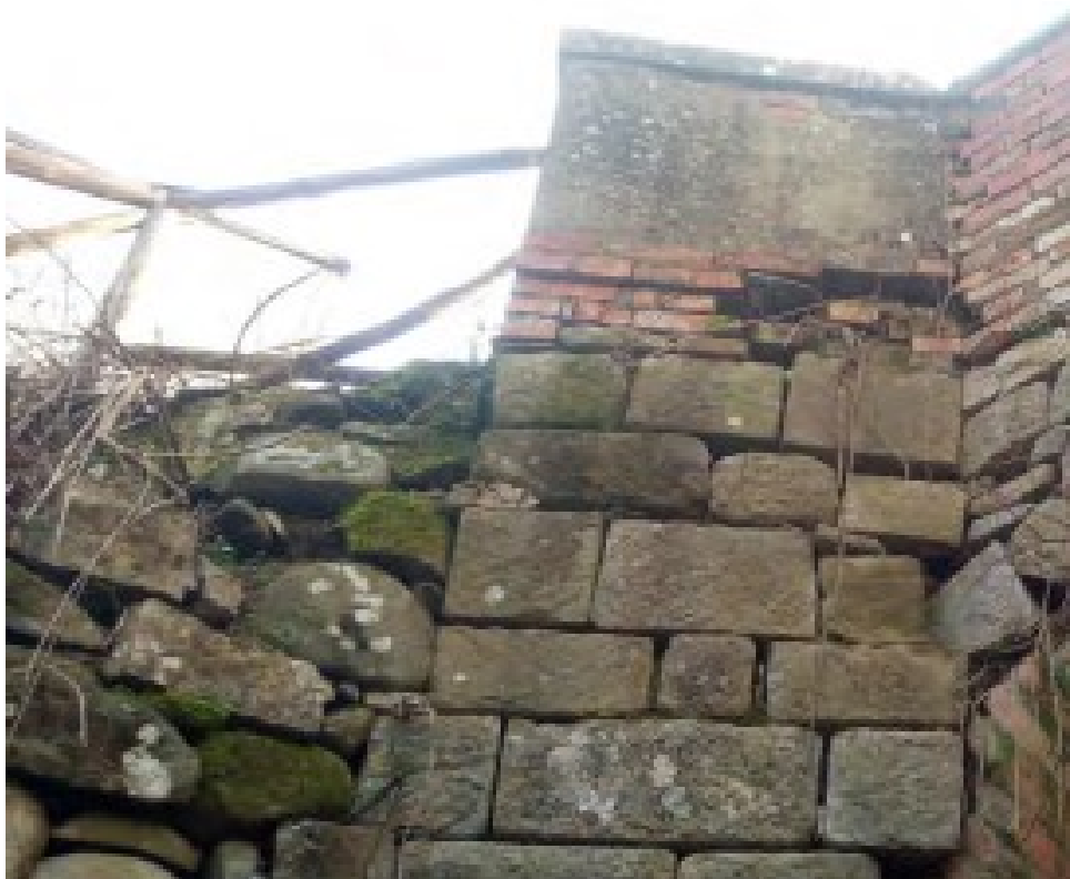
Figura 20 Vista su allentamento maglia muraria dei muri d'ala
