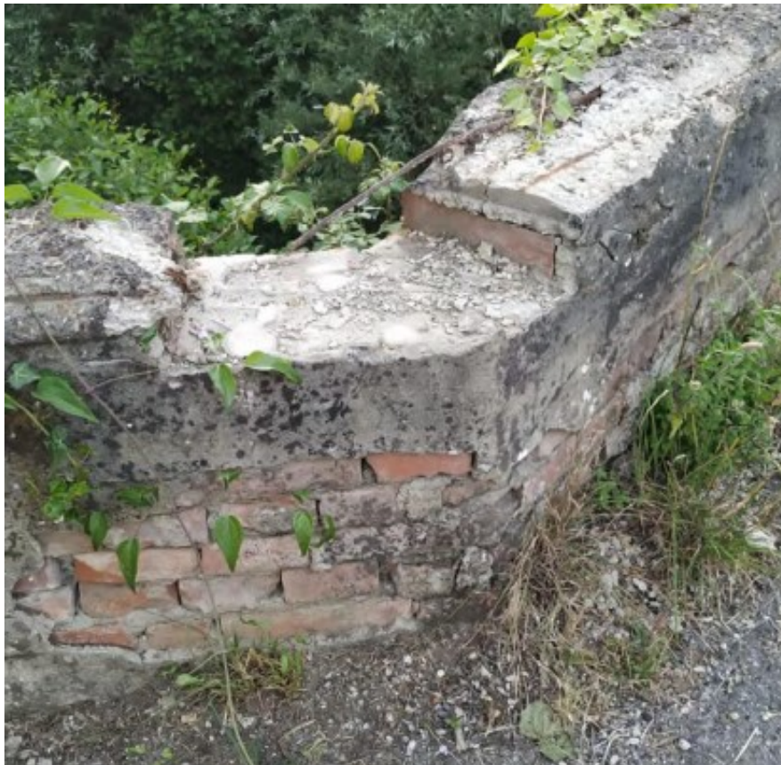
Figura 23 Vista sul parapetto con porzione danneggiata
