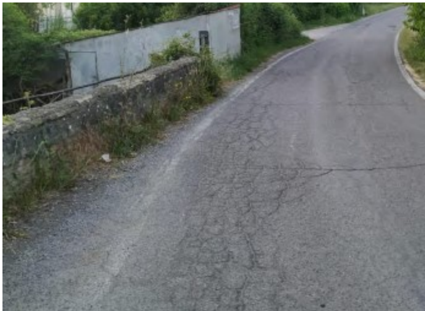
Figura 24 Vista sulla pavimentazione stradale dissestata
