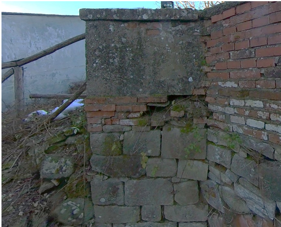
Figura 21 Vista su muro d'ala con vegetazione infestante
