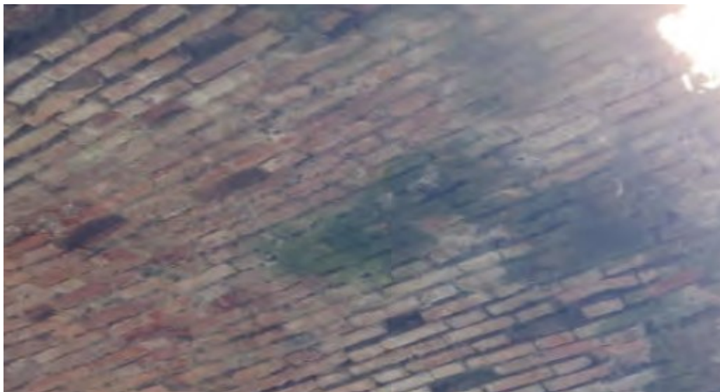
Figura 22 Vista all'intradosso della volta con infiltrazioni e muffe
