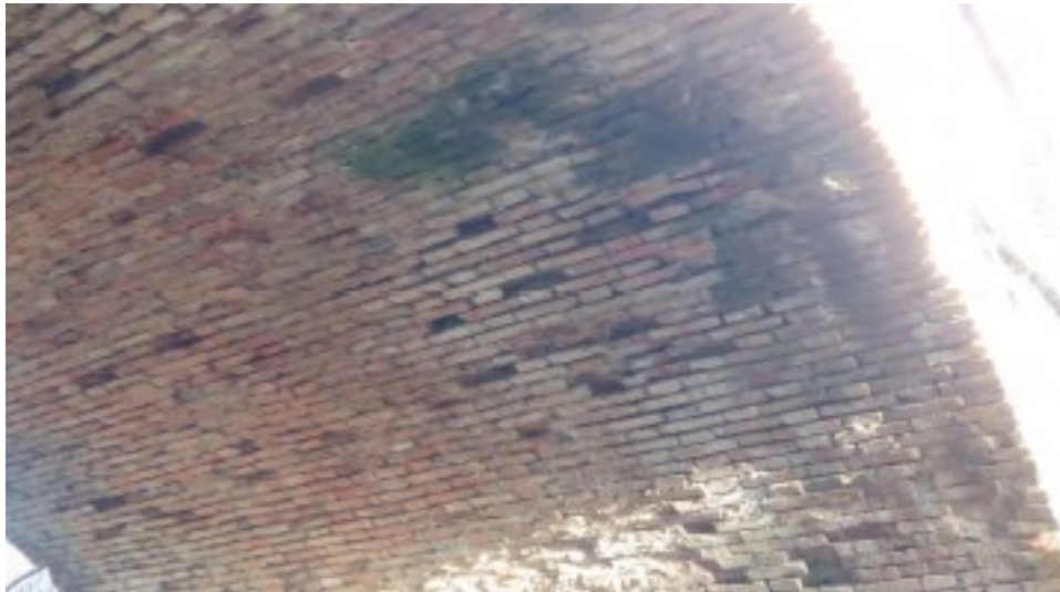
Figura 19 Vista su intradosso della volta con distacco di mattoni
