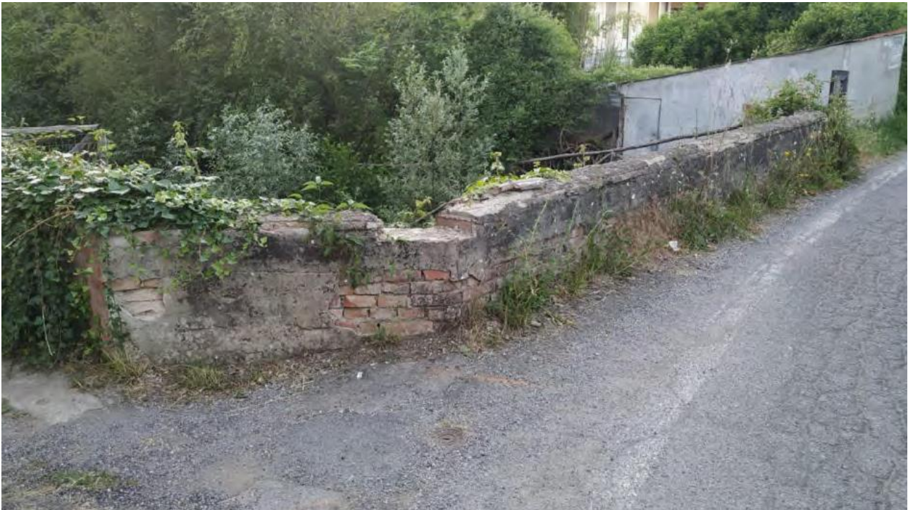
Figura 6. Degrado del parapetto in muratura
